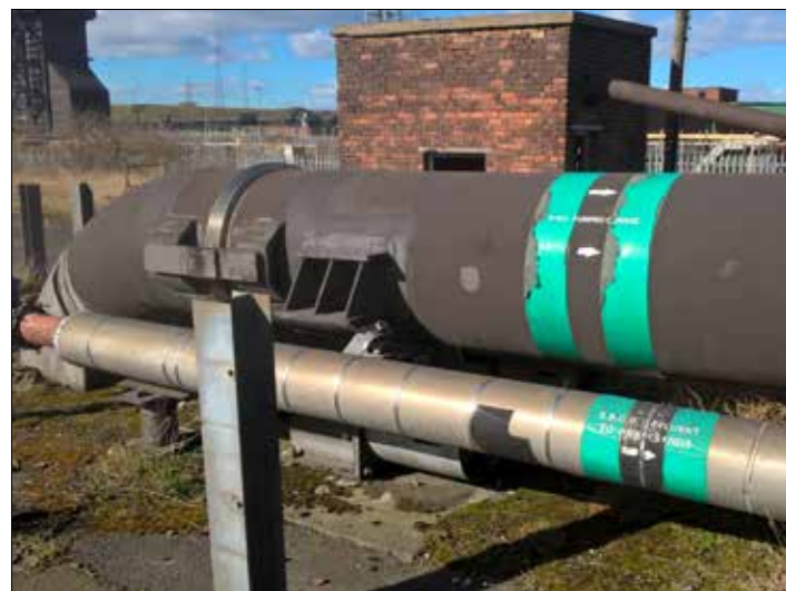
NWL effluent transfer mains
